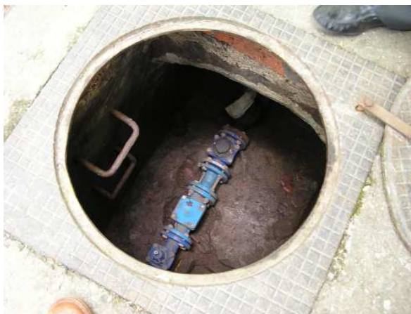
Camin al contorului de bransament propriu unui condominiu – Bloc H, Drumul Taberei
