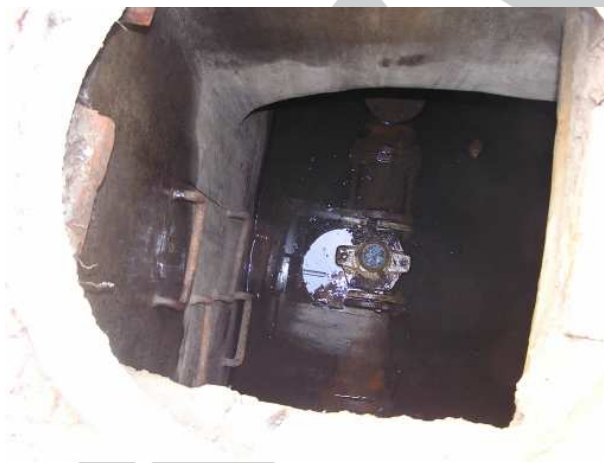
Camin al contorului de retea, pe baza caruia se masoara si se factureaza apa consumata de mai multe blocuri de locuinta, condominii (cladiri) independente - exemplu de practica contrara prevederilor reglementarilor si contractului de concesiune, in cartierul Dr. Taberei
